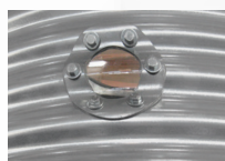
Janela de inspeção Funil Primeiro Anel
